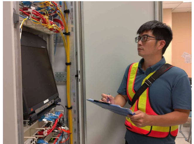
▲ 號誌系統機房設備檢視。
